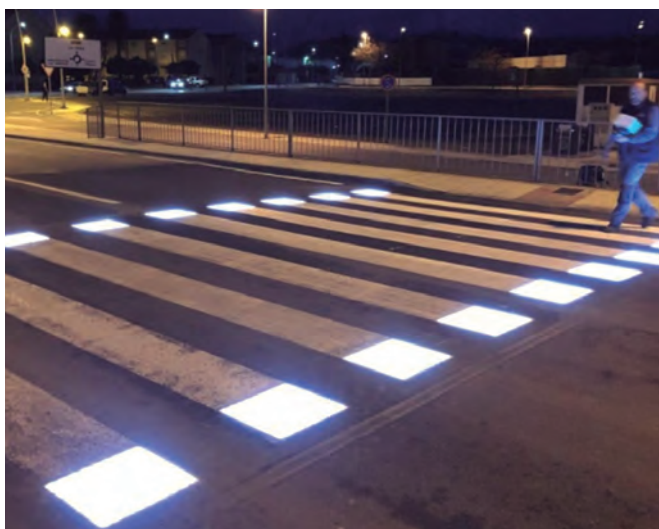
Paso peatonal con luces led laterales para aumentar la visibilidad a los conductores y la seguridad a todos los peatones.
