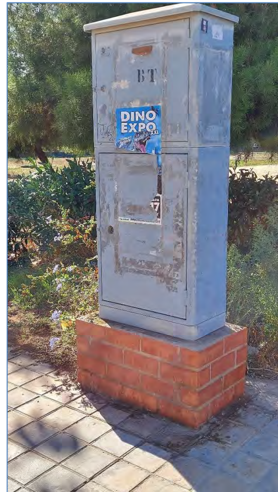
Foto 19: Armario de BT en esquina de carretera de Llíria.
