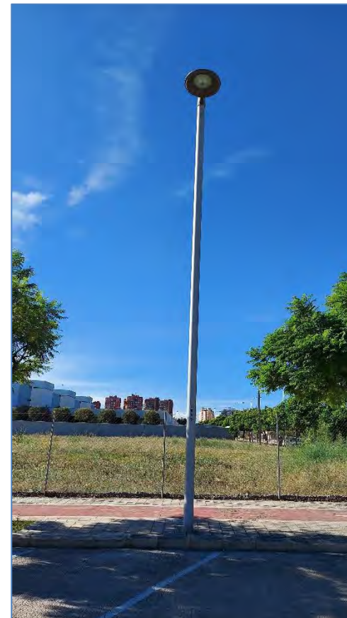
Foto 3: Columna y luminaria existente en calle catedrático Escardino.
