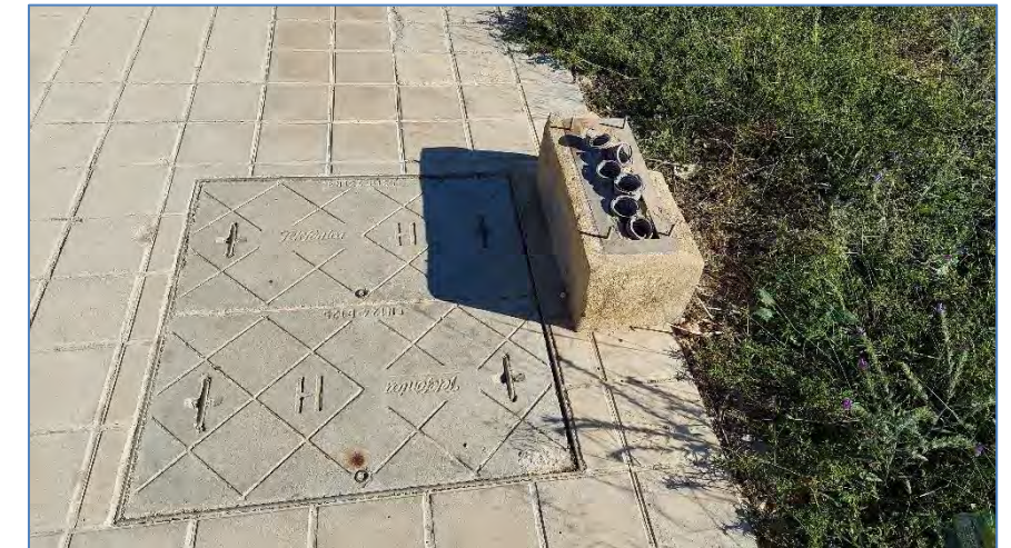
Foto 11: detalle de arqueta H de telefonía existente en calle catedrático Escardino.
