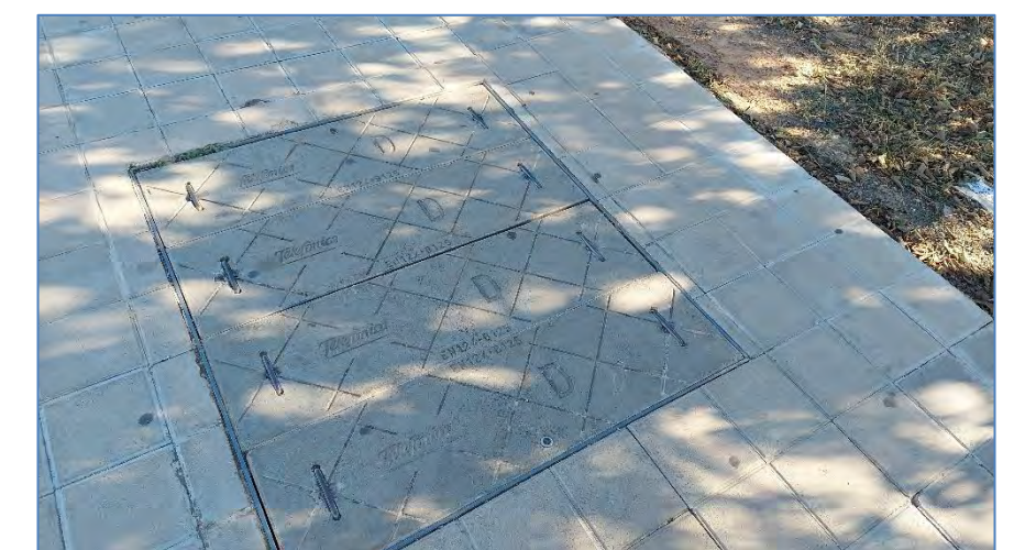
Foto 16: Arqueta D de telefonía en esquina de catedrático Escardino con carretera de Llíria.
